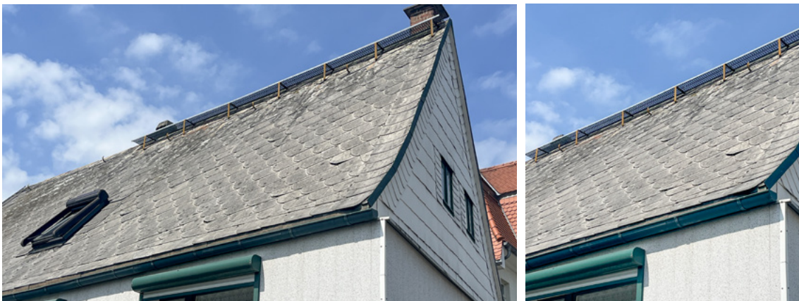
Abbildung 6: Asbesthaltige Dacheindeckung an Wohngebäuden (Fotos: © E. Hennings)
