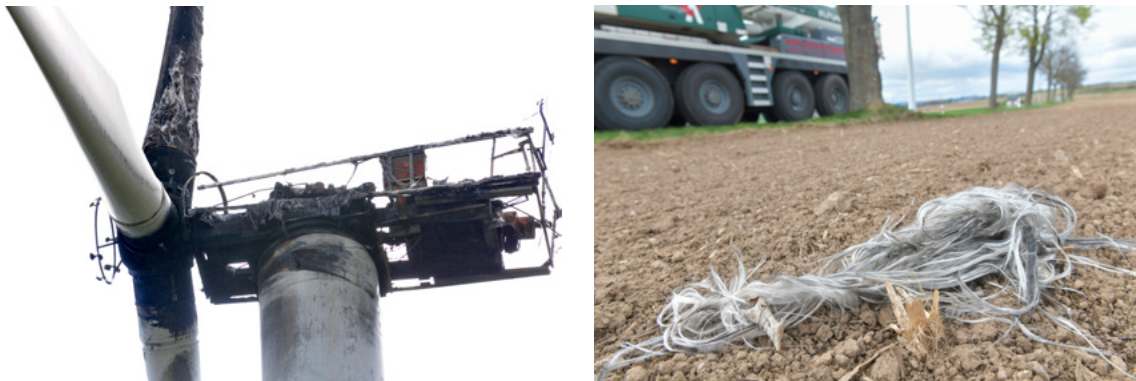
Abbildung 12: Brand einer Windkraftanlage mit Freisetzung von Faserstoffen (Fotos: © E. Mildner)
