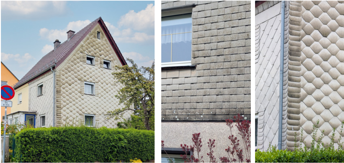
Abbildung 8: Asbesthaltige Platten an Außenwänden von Gebäuden (Fotos: © S. Hennings)
