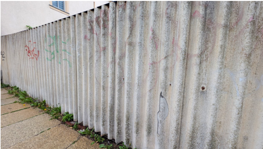
Abbildung 9: Asbesthaltige Außenwand als Abtrennung (Foto: © S. Hennings)
